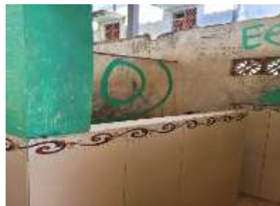
Gambar 2: Kondisi Kamar Mandi Tanpa Penutup
