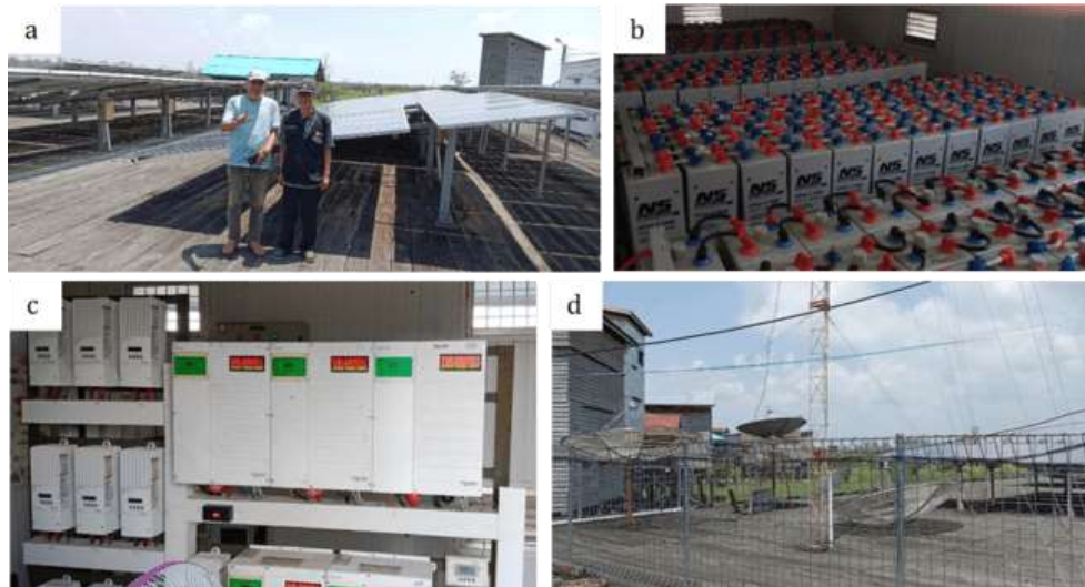
Gambar 8. Kegiatan survei lapangan di PLTS sistem komunal Desa Muara Enggelam (a) foto bersama dengan operator PLTS; (b) baterai penyimpanan PLTS; (c) inverter PLTS; (d) jaringan penyalur listrik PLTS.
