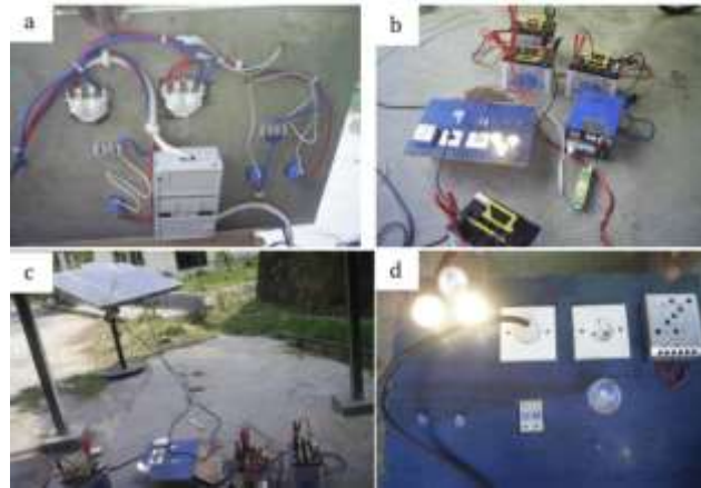
Gambar 4. Alat dan Bahan Demonstrasi Teknologi Sel Surya Sistem Off-Grid (a) paket inverter; (b) paket battery banks (c) paket sel surya off-grid (d) saklar dan lampu neon.
