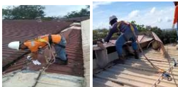
Gambar 2. Dokumentasi Pekerja Tidak Menggunakan APD Dengan Benar
